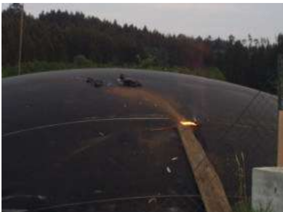
Image 9: 5. Test de feu avec une torche : fuite de biogaz par le trou fait par la combustion de la torche; un chiffon enflammé est utilisé pour être sur que le gaz prend bien feu.
